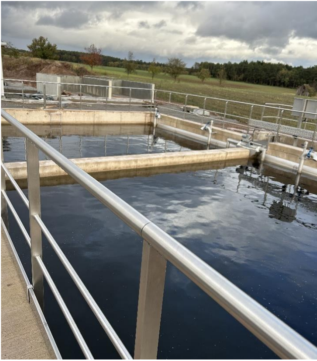
Klärbecken in der neuen Kläranlage Flachslanden
