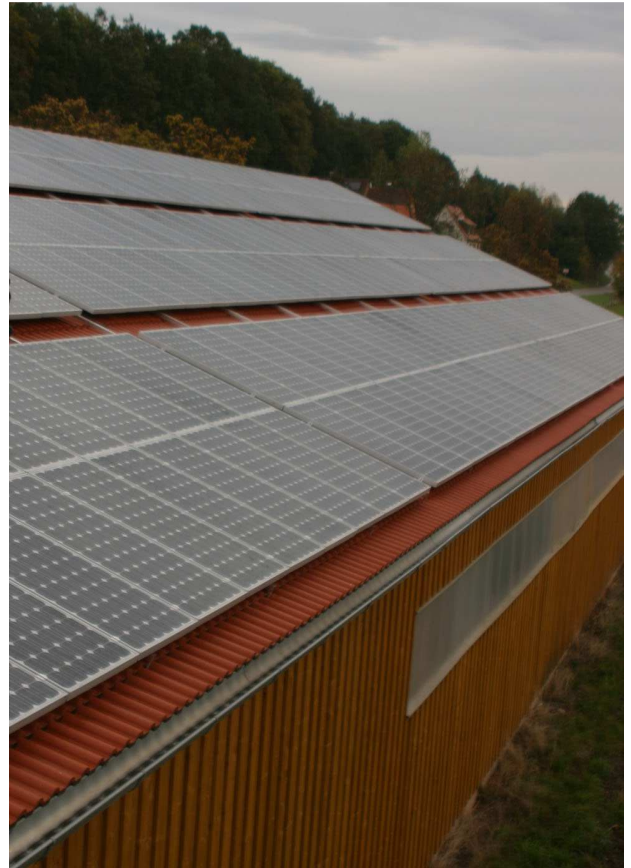
Photovoltaikanlage mit Wartungswegen - Wartungswege, wie hier auf dem Foto vorbildlich umgesetzt, erleichtern die Arbeit auf dem Dach und machen sie wesentlich sicherer.
