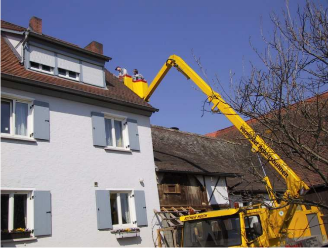
Hubarbeitsbühne - Eine ideale Möglichkeit für Reparaturarbeiten auf dem Dach bietet der Einsatz einer Hubarbeitsbühne, die es mit Auslegern von bis zu 24 Metern gibt, und die stunden- oder tageweise ausgeliehen werden kann.
