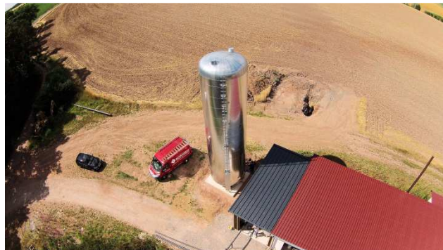
Pufferspeicher und Technikraum in derzeitigem Bauzustand
