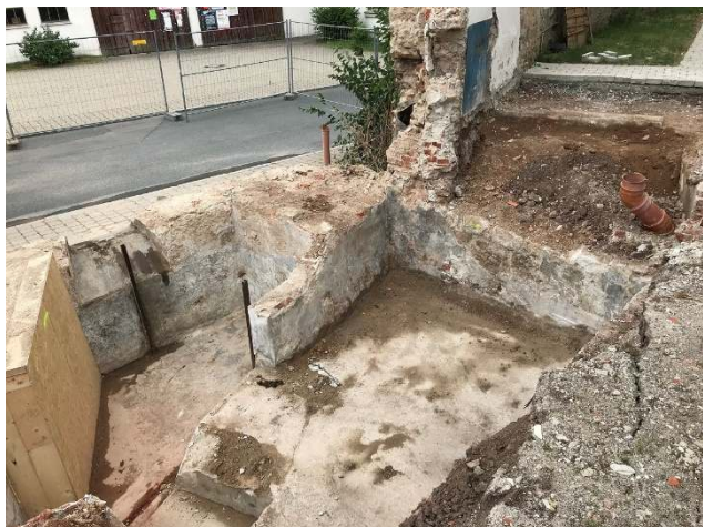
Der Anschluss für das Wärmenetz (in der Holzverschalung)
