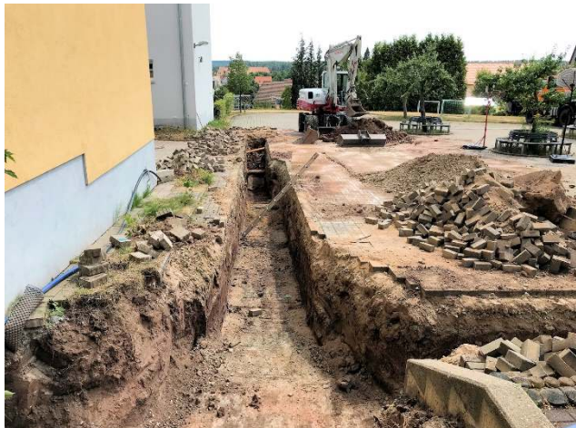
Der Graben für die neuen Heizungs-, Wasser- und Elektroleitungen von der Schule in das Rathaus
