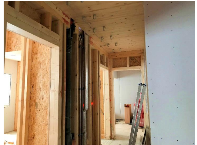
Blick in den Flur mit den Zugängen zu den beiden Sprechzimmern und zum Therapieraum
