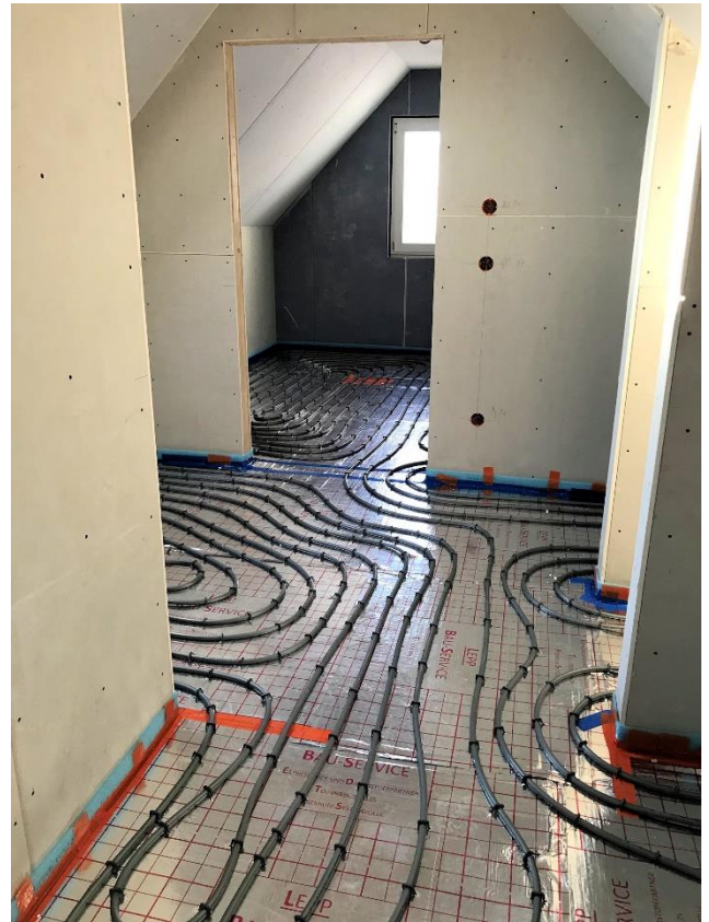
Fußbodenheizung in der Wohnung im DG
