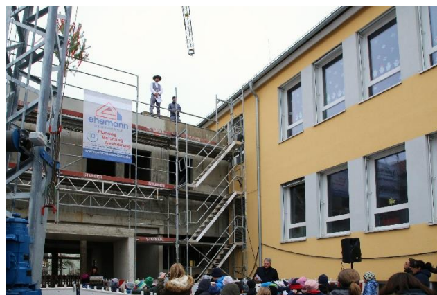
Unser Foto zeigt den Richtspruch durch den Maurermeister Johannes Förster. Foto: Alexander Biernoth
