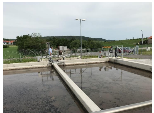
Belebungsbecken in der Kläranlage Lehrberg
