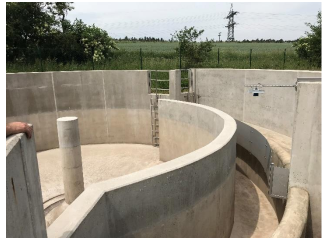
Regenrückhaltebecken am Pumpwerk in Ketteldorf
