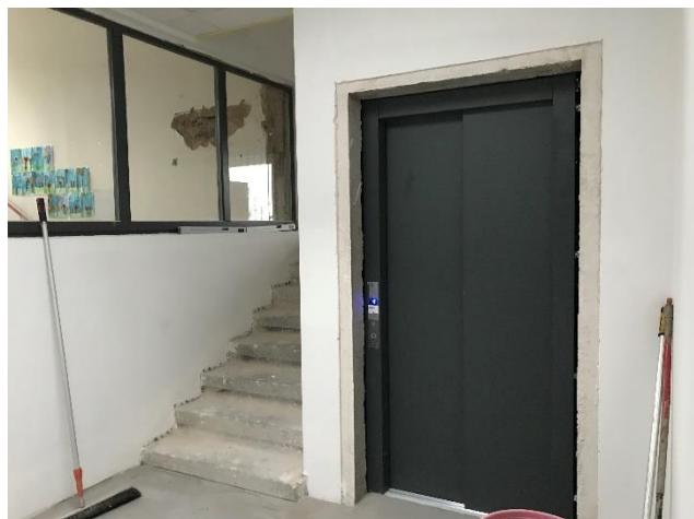
Der Aufzug im Obergeschoss des Neubaus
